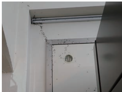
はめ込み窓のすき間から侵入するアリ
