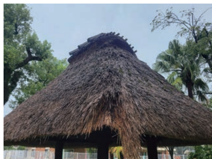
台風後損壊状況
