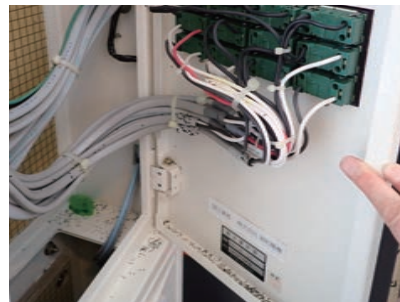
配電盤に侵入したアリ
