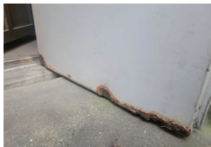
鉄の劣化修理箇所
