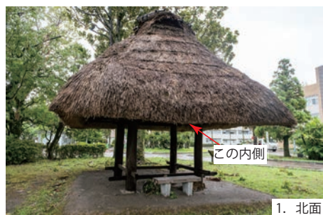
2024年台風10号に伴う奄美の高倉 構造物折損状況
