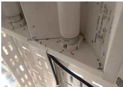
ダクトレール・ケーブルラック・天井照明に大量侵入している
