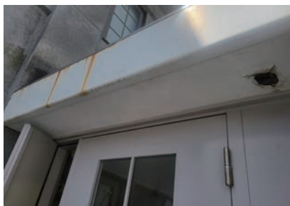
サビ・漏水修理箇所
