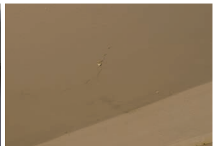
展示室内 2F 大雨時漏水
